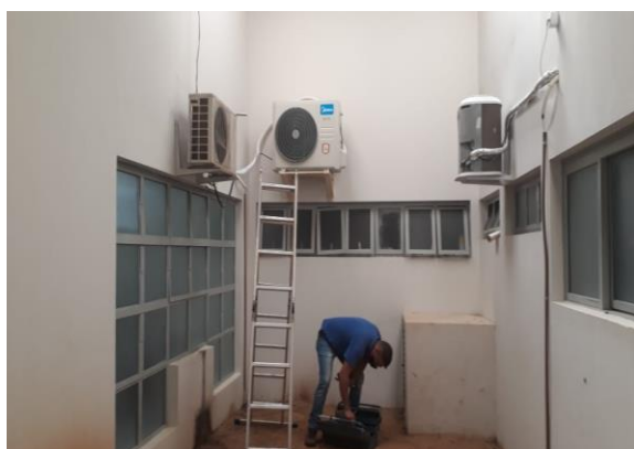
Aparelho de Ar Condicionado
